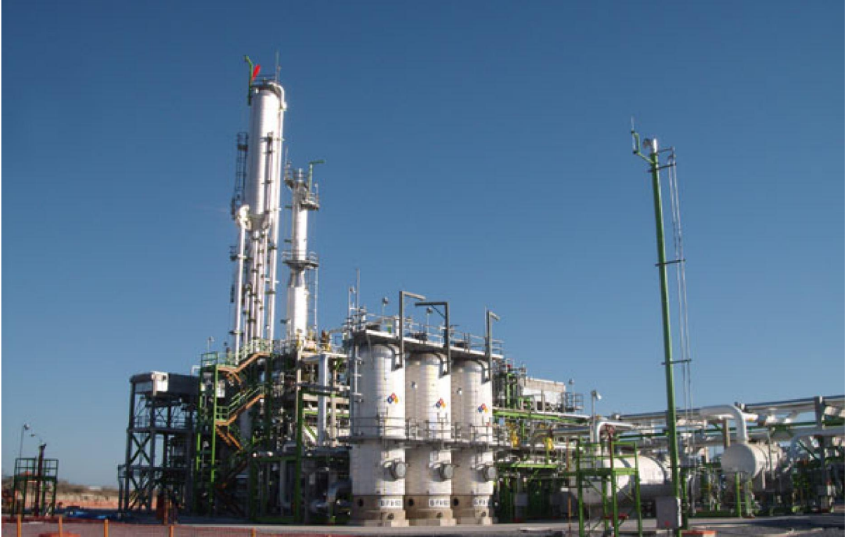
Şekil II.2.1. Doğalgaz Kombine Çevrim Santrali Temsili Resmi
